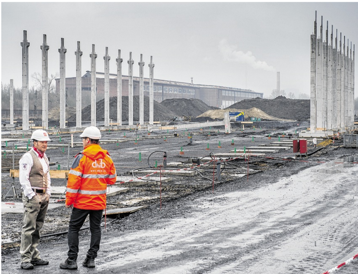
Das Instandhaltungswerk für den Rhein-Ruhr-Express entsteht auf dem Gelände eines alten Güterbahnhofs in Dortmund. Im Bild gut zu sehen: die Stützen für die über 160 Meter lange Wartungshalle. FOTO: KAI KITSCHENBERG
