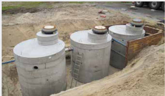
Abscheideranlagen, Vattenfall Europe AG
